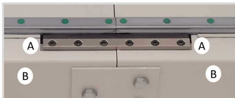
Figure 6. Emplacements où des fissures peuvent se produire
