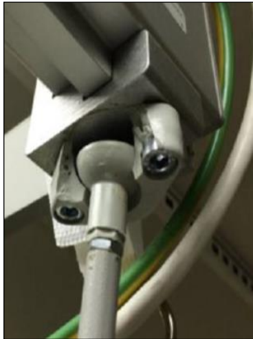
Boîtier de palier en plastique cassé
