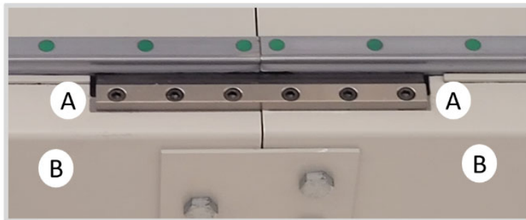
Figura 6. Punti in cui possono verificarsi incrinature
