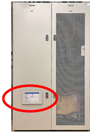
Figure 2 : porte avant de l'armoire de refroidissement (LCC)
