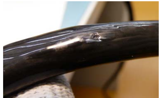
Figura 8: Cavo Motore danneggiato
