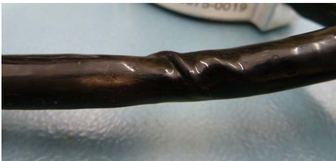
Figure 7 : Câble Moteur endommagé
